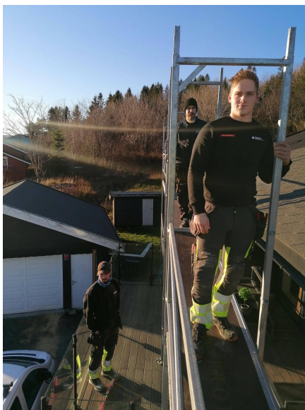
Rissa Kraftlag har solcelleinstallasjon på enebolig på Fosen.
